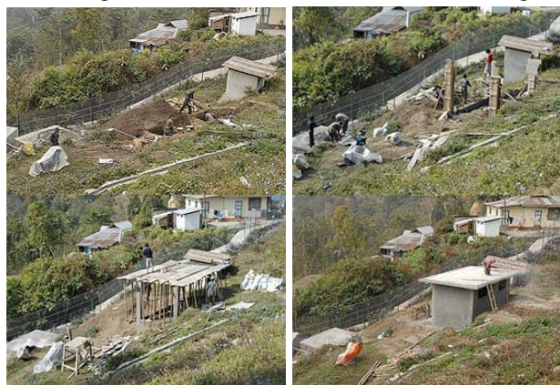
Für den Generator veranlasst Karmapa den Bau eines Häuschen – inzwischen steht der Generator mmonsungeschützt im Innern und liefert wetterunabhängigen Strom für alle Gebäude.
